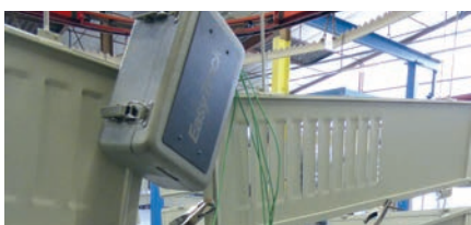
CONTRÔLE TEMPÉRATURE FOUR
